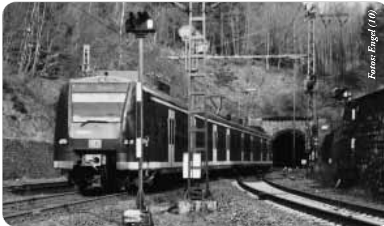
Der Altenbekener Tunnel ist schadhaft. Eine neue Tunnelröhre neben dem alten Tunnel ist nach dem Bundesschienenwegeausbaugesetz finanzierbar – die Sanierung des alten Tunnels nicht.
